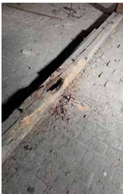
Poškozený vazný trám krovu nad tělocvičnou patřil podle technického posouzení z roku 2024 mezi nejzávažnější závady
