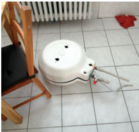
Hlavní viník, upadlý bojler.
