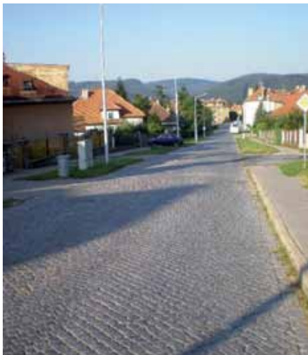
Současný stav vozovky na ulici Černo-horská. Foto: Dušan Kalášek
